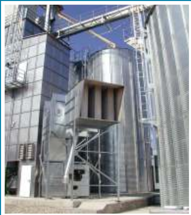
Silo mit Trocknungsanlage
